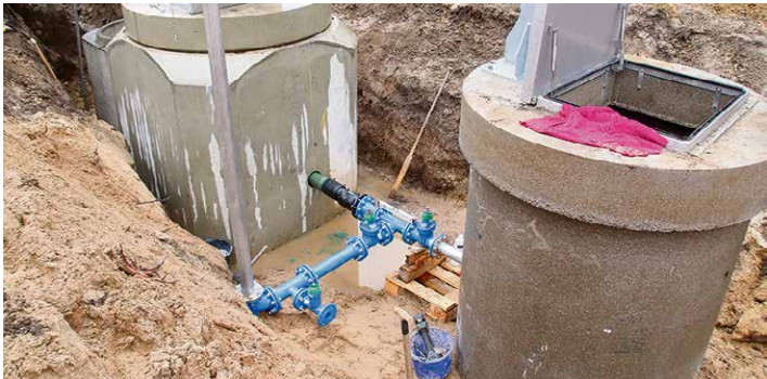
Schächte und Molchschleusen sind in das neue Entwässerungssystem eingebunden.
