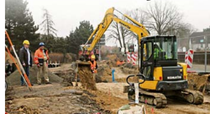
Peter Klimas (li.) vom ZV KÜHLUNG bespricht vor Ort in Kühlungsborn den Baufortgang.
