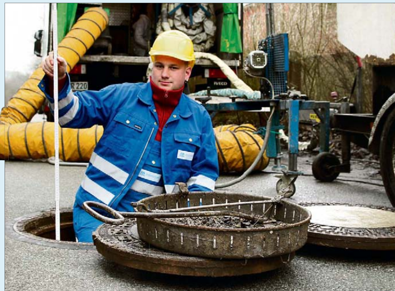
Mitarbeiter Markus Mross überprüft am Rande einer Schachtsanierung die Tiefe des Schachtes.
